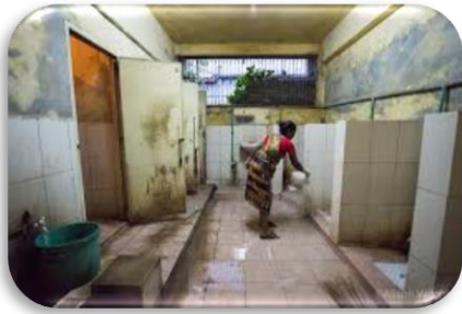
Fig: Unhygienic floor male toilet
